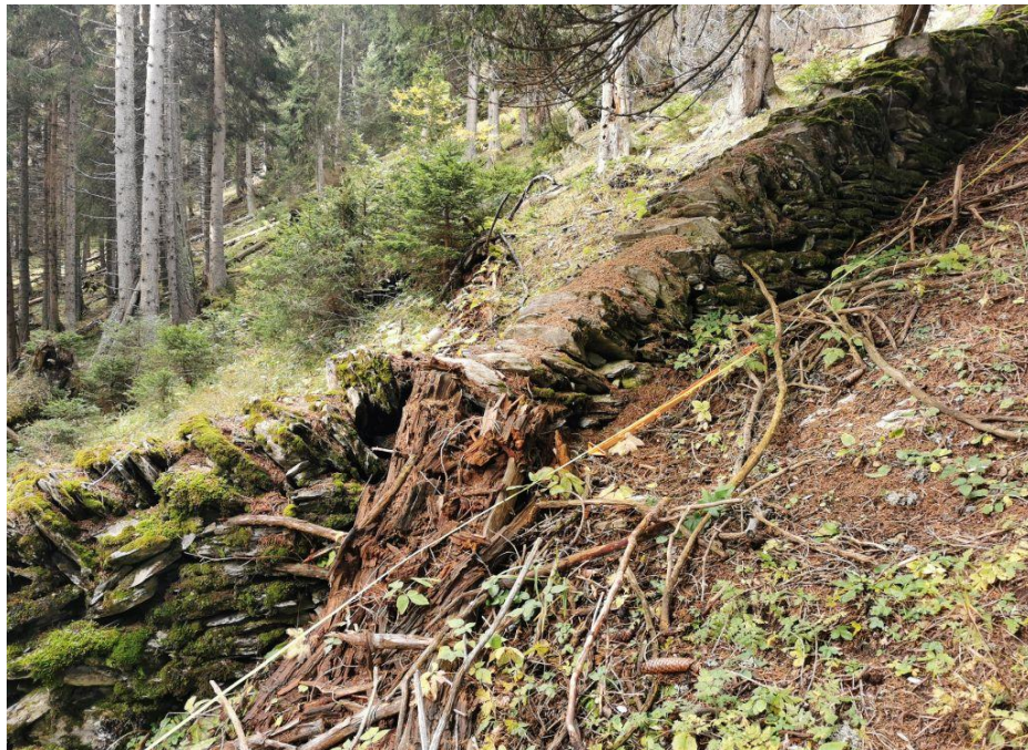
Abbildung 5: Schadstelle im unteren Abschnitt der Grenzmauer auf ca. 1'577 m Höhe
