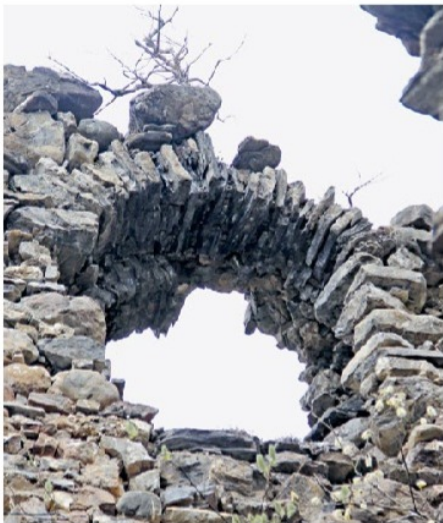
Ein Rundbogen-Fenster am Nordannex mit einem sich in Auflösung begriffenen Mauersturz im Bestand.
