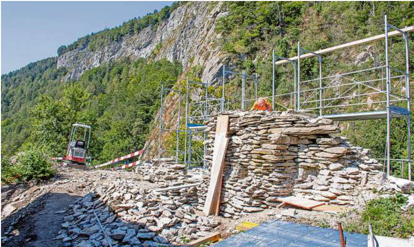
Gefährdet: An der bergseitigen Mauer lässt sich gut erkennen, dass die Steine nur lose aufeinanderliegen.
